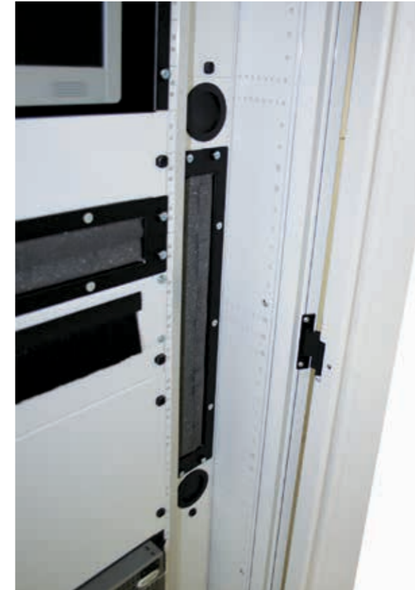
Rack waarbij luchtstroomoptimalisatie producten zijn toegepast
